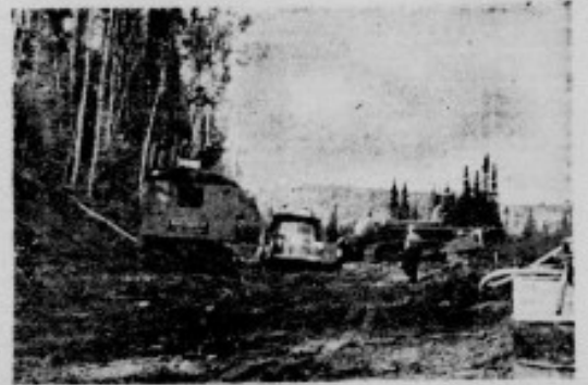
● Une pelle mécanique et un pulvérisateur "bull-dozing" en train de déblayer la route et d'en adoucir les pentes.
